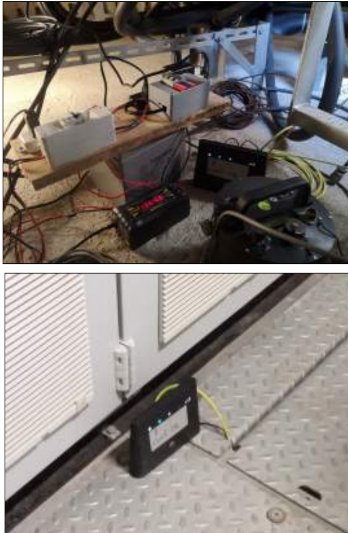
Figura 4. Instalación de la estación TCOA2.
