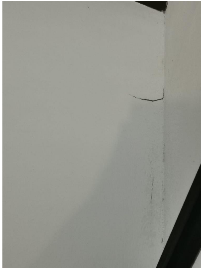
Figura 3. Fisura en pared.
