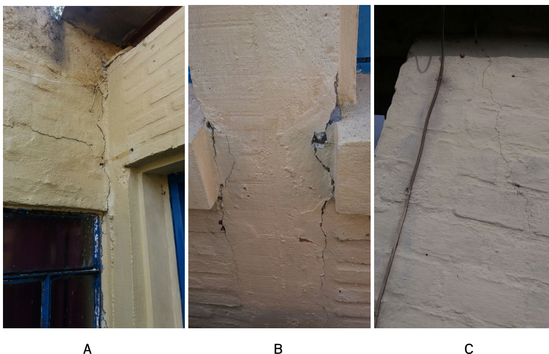
Figura 1. A y B) Rajaduras y roturas visibles dentro y fuera de la escuela C) Rajadura en las viviendas cercanas.
