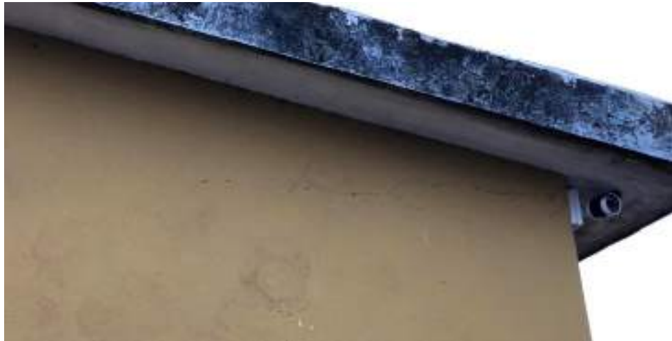
Figura 3. Ejemplo de grietas (horizontal en la viga corona?) formadas con las detonaciones en la cantera en la Subcomisaría de Pintadito.
