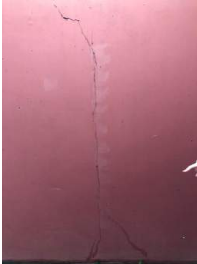
Figura 7. Ejemplos de fisuras en paredes
