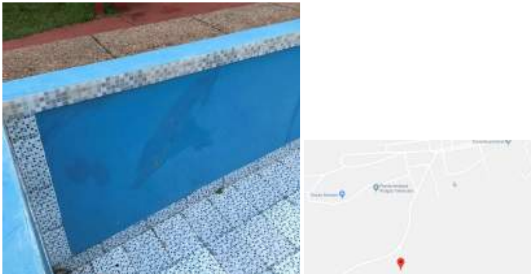
Figura 4. Posible fisura por voladura en piscina. Localización del punto.
