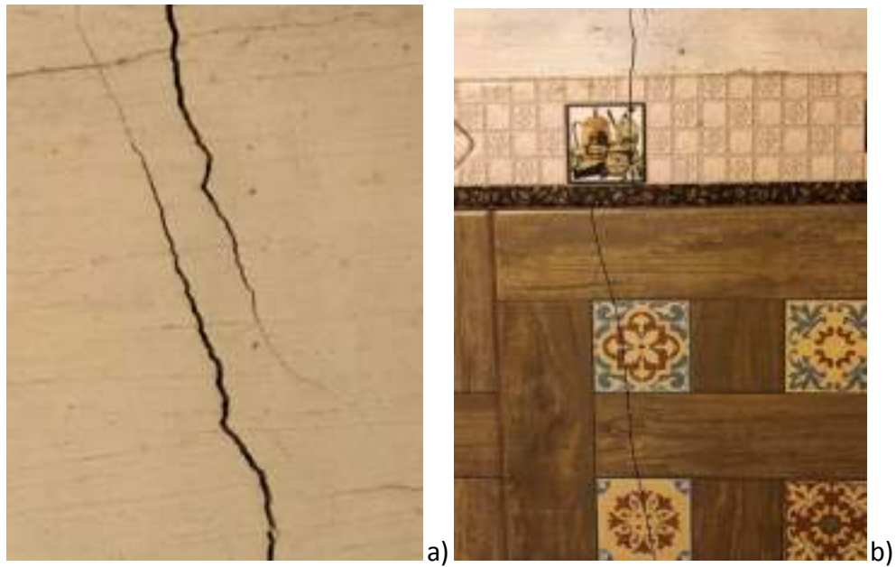
Figura 5 a y b) Grietas moderadas escalonadas y mortero fisurado.
