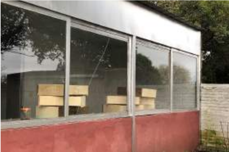
Figura 3. Foto mostrada rajadura en ventanal del Caif.
