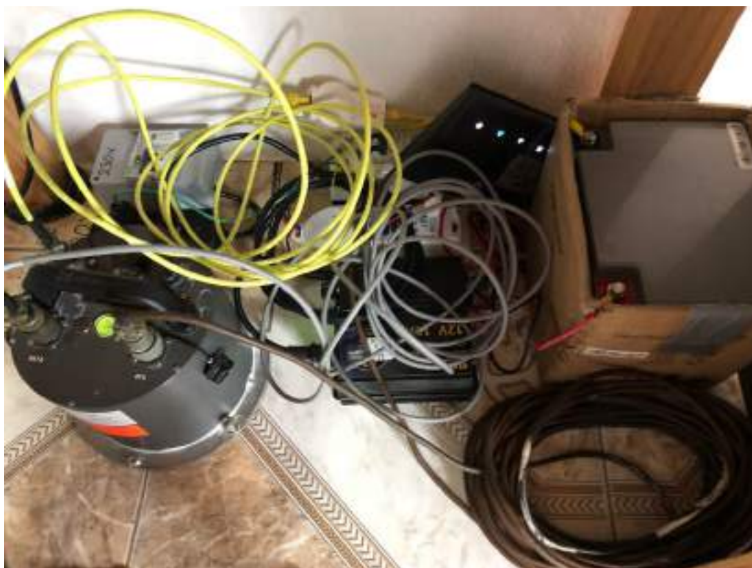
Figura 8. Acelerómetro instalado en Caif.
