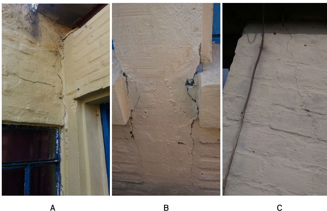
Figura 1. A y B) Rajaduras y roturas visibles dentro y fuera de la escuela C) Rajadura en las viviendas cercanas.
